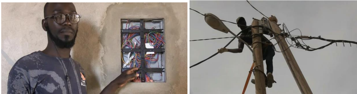
Foto links: Syabou Sylla aus Goumal (10 km von Waounde) erklärt einen Sicherungskasten. Foto rechts: Idrissa Djire aus Waounde verlegt in Gagny bei Dakar ein Leitungsnetz.
